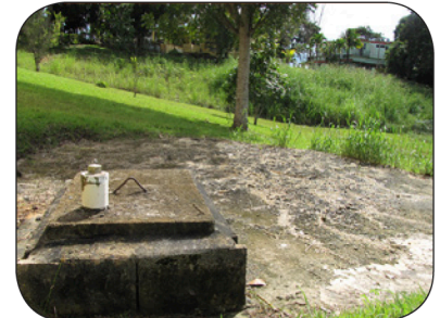
Mantenga el pozo séptico sellado.
